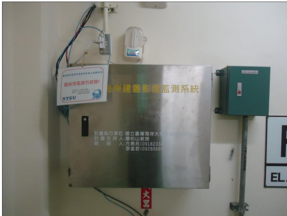
圖 3-15 觀測站主機機箱
